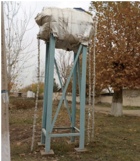
簡易給水タンク
