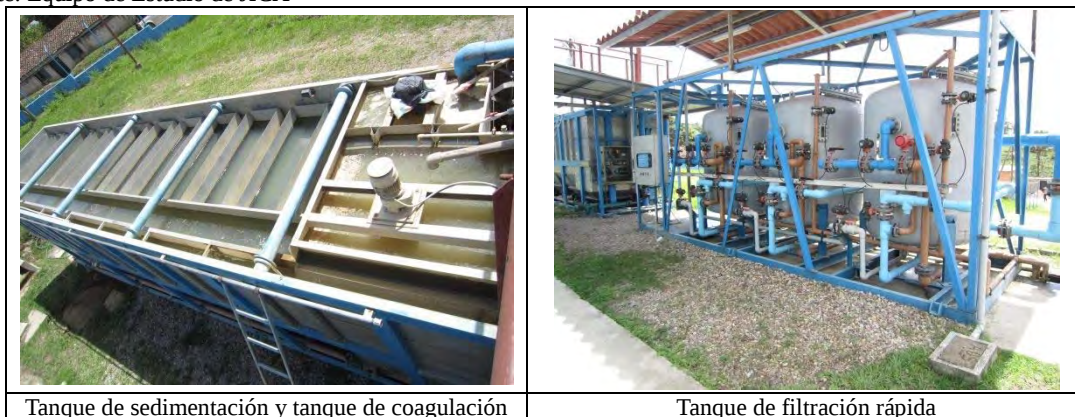
Fotografía 2 Sistema de potabilización del mismo tipo instalado en 4 plantas potabilizadoras de la Ciudad de Siguatepeque (Fuente: Equipo de Estudio de JICA)
