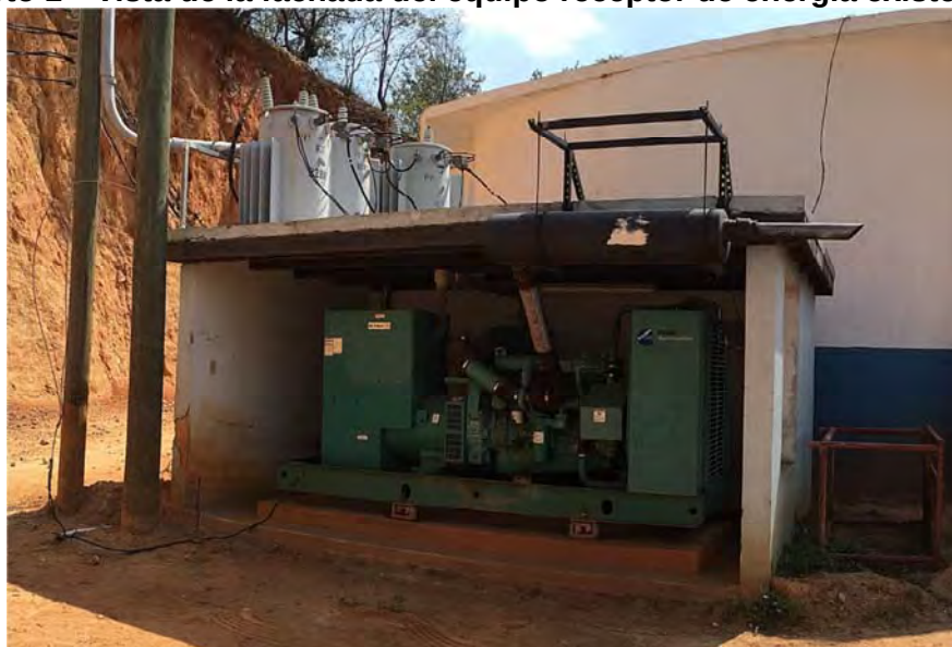
Foto 1 Vista de la fachada del equipo receptor de energía existente
