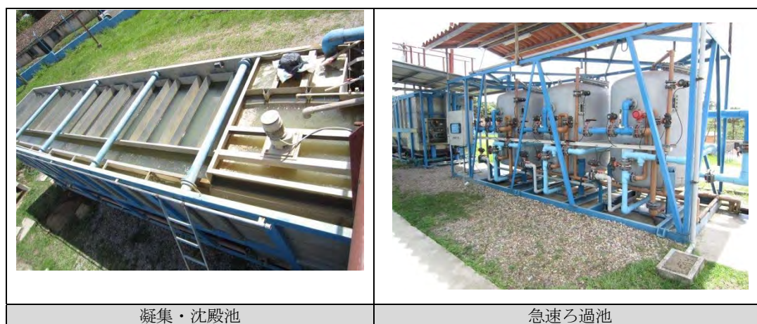
写真 2 シグアテペケ市グワトロ浄水場に設置されている同型の浄水施設
