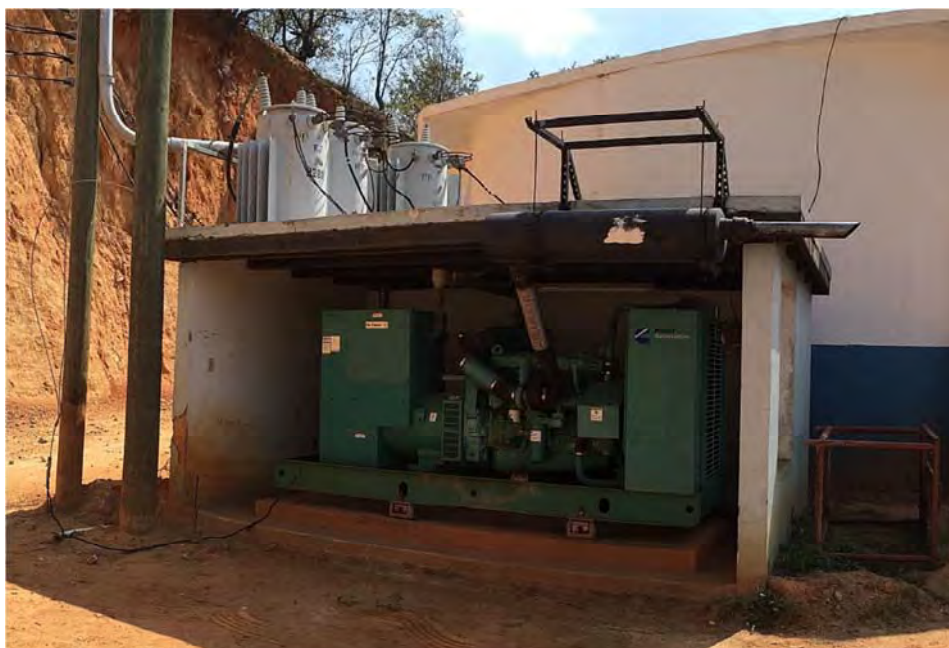
写真 4-1 既設受電設備外観
