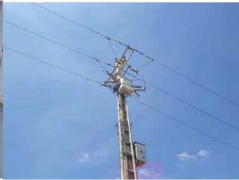
写真 2-8 架空線自動開閉器
