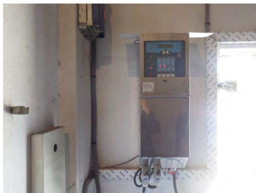
写真A-4 MV/LV 変圧器室の RTU (RAK)
