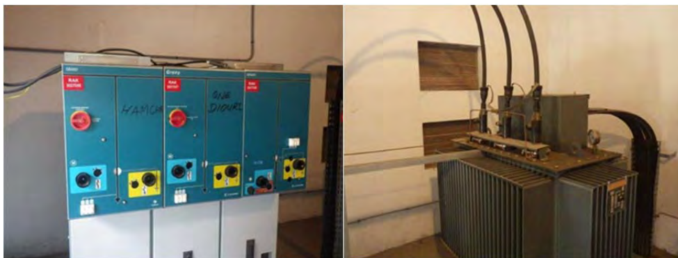
写真 2-5 MV 開閉装置 (3回路)
