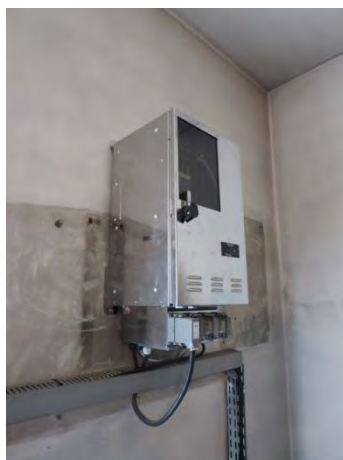
写真 A-6 MV/LV 変圧器室の RTU (Redal)
