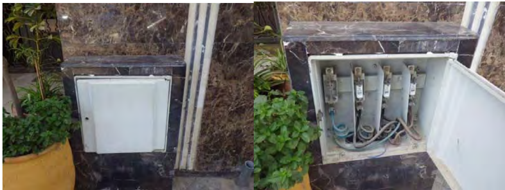
写真 2-9 LV ケーブル用分岐装置
