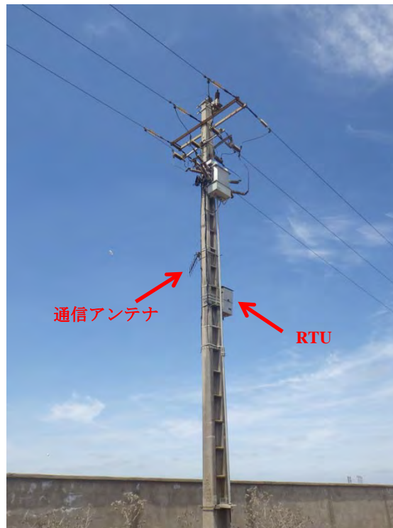
写真 A - 2 架空線開閉器用の RTU (RAK)
