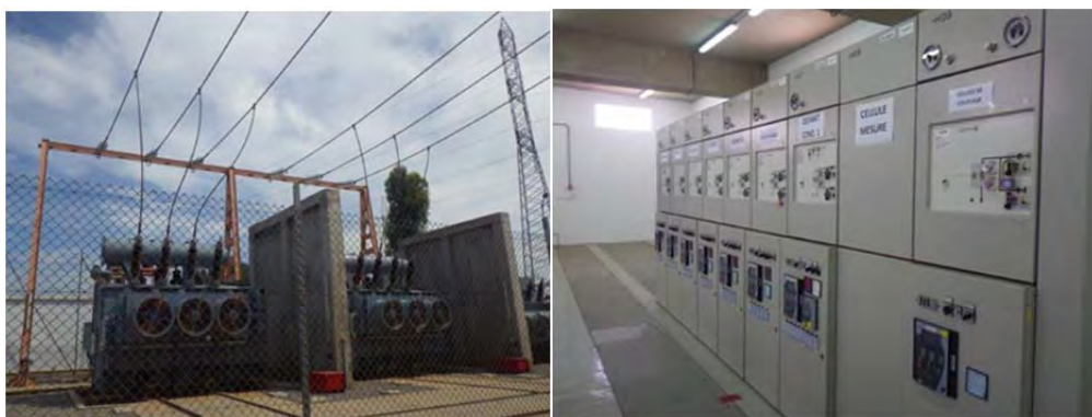
写真 2-1 60/20kV 36MVA 変圧器 (NEXANS 製) 写真 2-2 配電線用遮断機 (Schneider 製)
