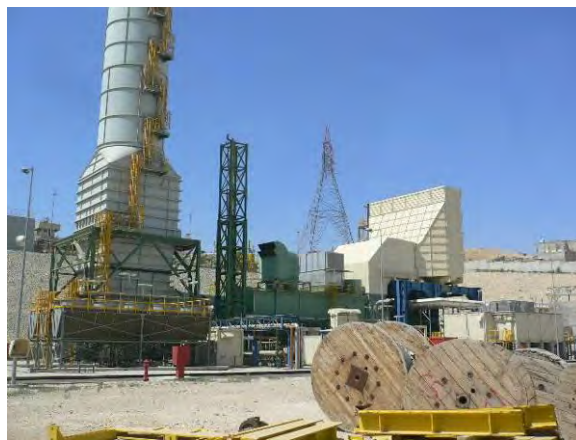
発電設備外観 (UnitNo.7)
