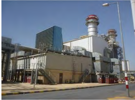
発電設備外観(IPP1)
