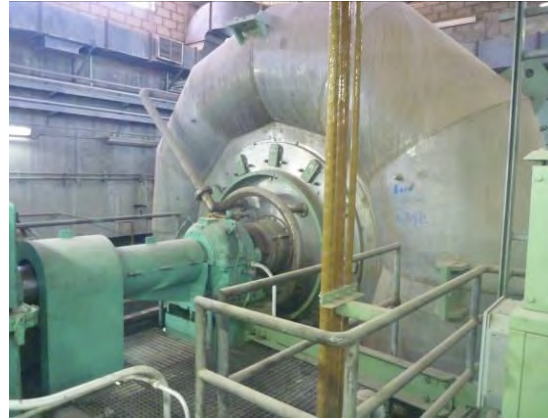
放水路小水力発電設備(Phase2)
