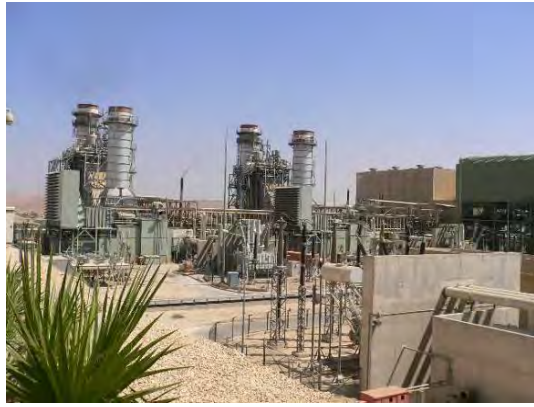
発電設備外観 (UnitNo.1,No,2)
