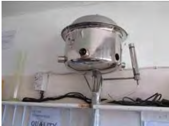
ラボ室：蒸留水製造装置 現在も使用している。
