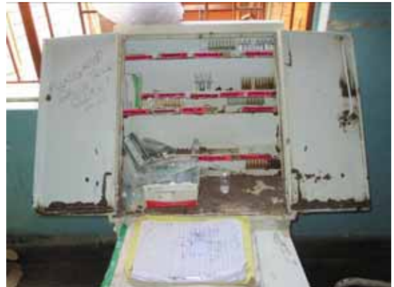
処置室：薬品キャビネット 老朽化が進み塗装が剥げ、扉の開閉に一苦労している。
