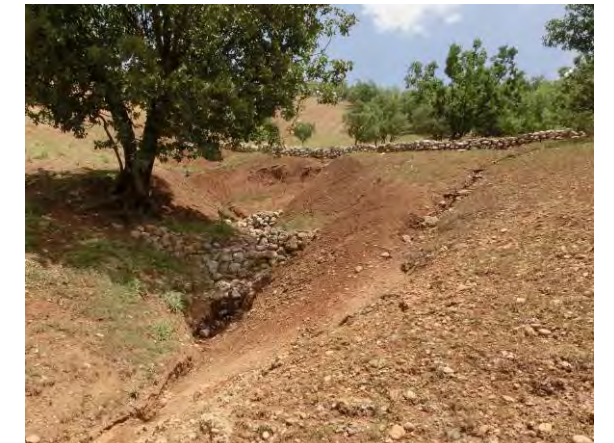
森林草地分野：大雨で上部堤体袖部から新規ガリーが発生し、補修工事を実施。(2015年4月、バズフト地区ドゥーラック・ソフラ村)
