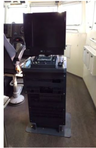
図 25 操作卓の設置後
