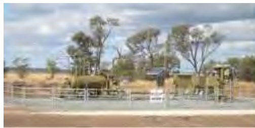
左：セパレータ・水タンク 右：坑井ヘッド・ポンプ・ ポンプ駆動用ガスエンジン
