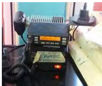
固定局端末 (St. James Parish 事務所)
