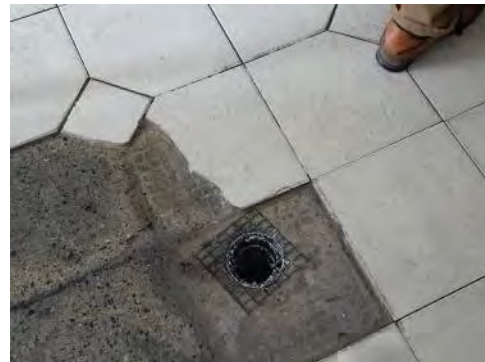
写真 5-12 整備不良の床
