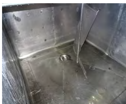
写真 5-6 タンク側面に汚れがある
