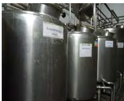
写真 5-5 洗浄装置 (CIP)
