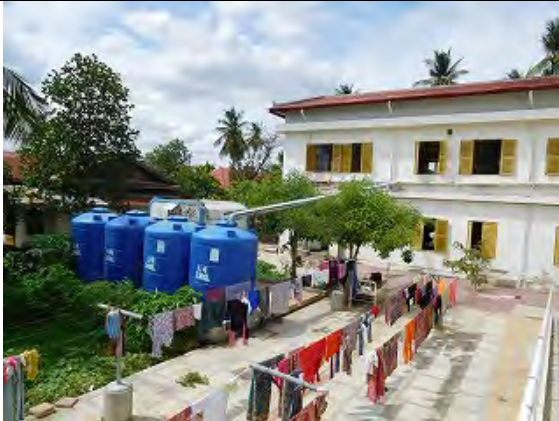
雨水集水タンク 洗濯用に使用
