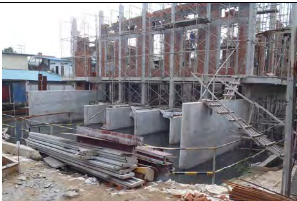
トルコーク地区でプノンペン都が独自に建設を進めているポンプ場（新トルコーク I ポンプ場）
