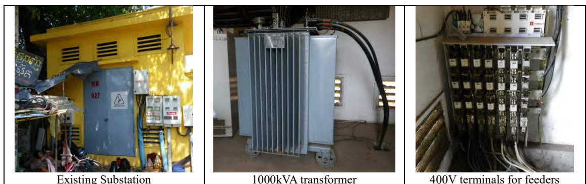
写真 R 3.2.1 6号ポンプ場に最寄りの既設変電所
