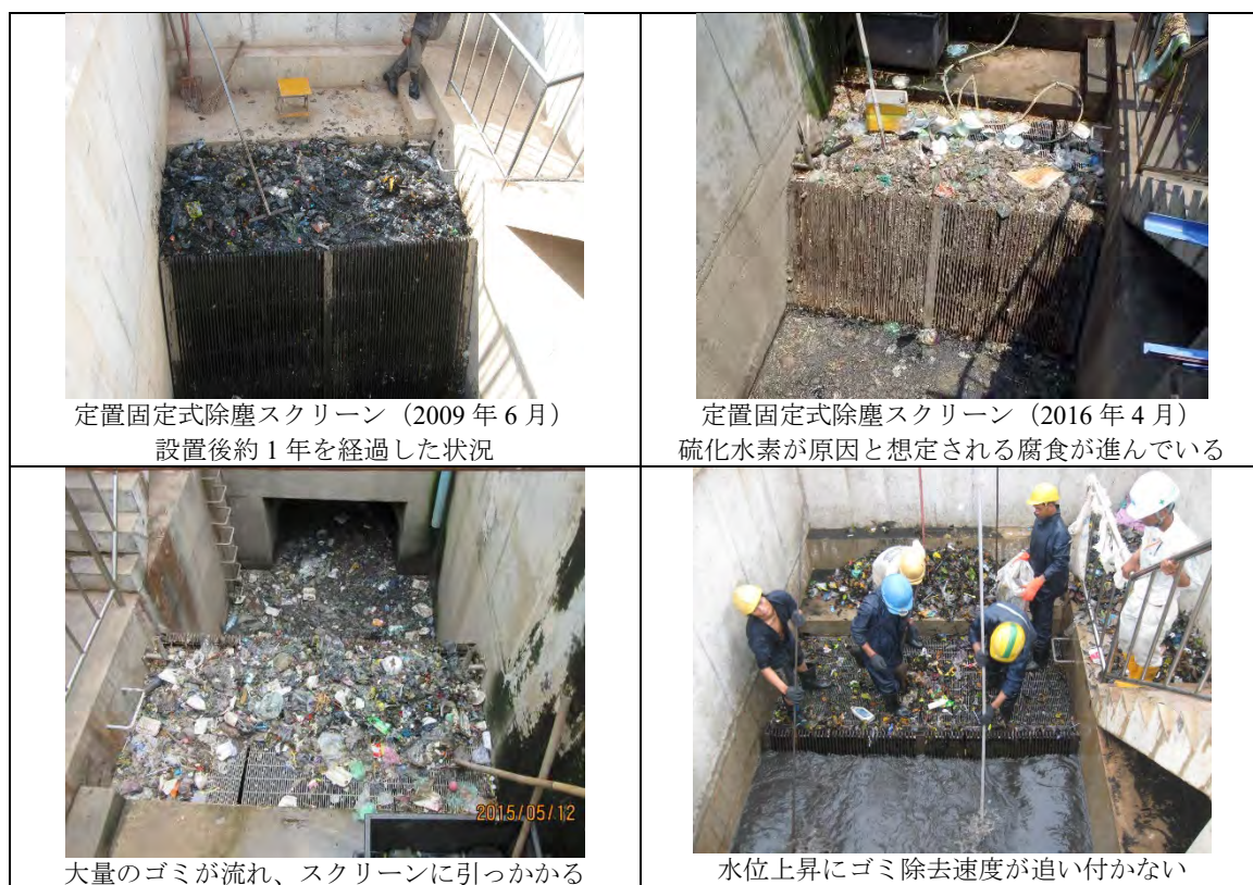
写真 R 2.1.2 フェーズ 2 で整備した排水ポンプ場の除塵スクリーンの現状
