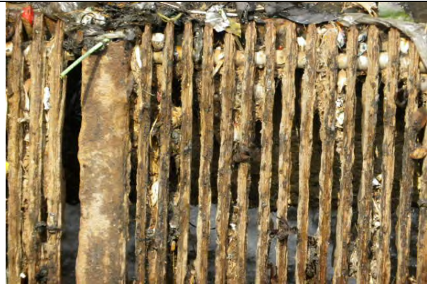
スクリーンピットにおける、著しく腐食の進んだ鉄製のバースクリーン (拡大)
