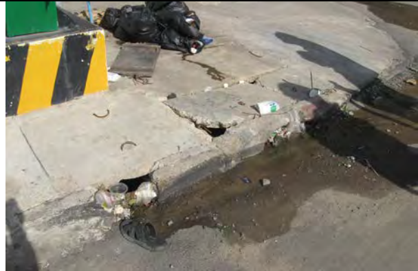
道路脇の排水溝入り口にゴミが入り込んでいく状況
