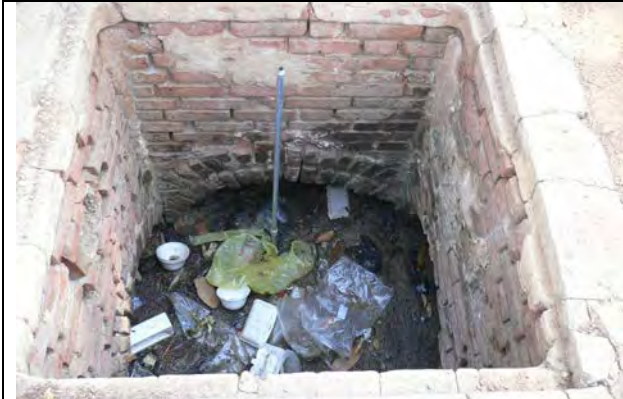
堆積物により排水管路の流れが阻害されている状況
