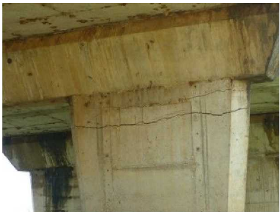
既設橋梁の損傷
