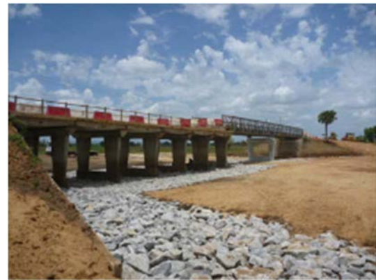
写真-4 メサロⅢ橋 2014年の洪水時に一部橋梁が落橋し、ベイリー橋により修復された。
