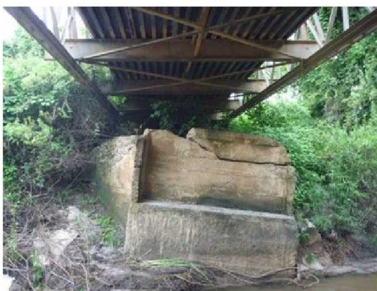
既設橋梁の損傷
