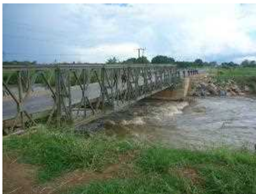
写真-5 マプエデ橋 ボックスカルバートが流出し、ベイリー橋により供用中。
