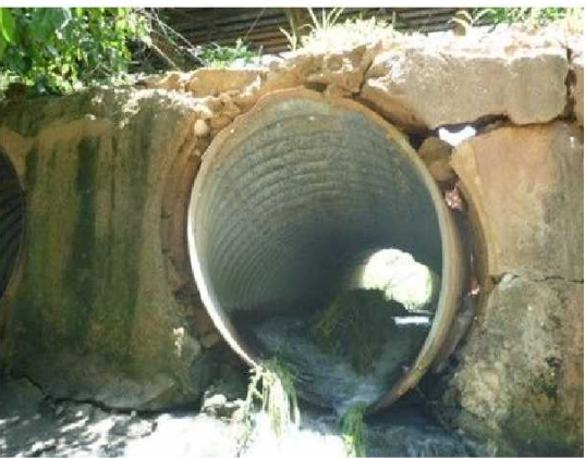
既設カルバートの損傷
