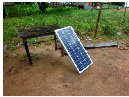
太陽光パネル
