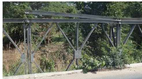
写真 3-2-2 カチプシ橋の損傷状況
