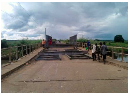
メサロ橋Ⅰのコンクリート床板の損傷
