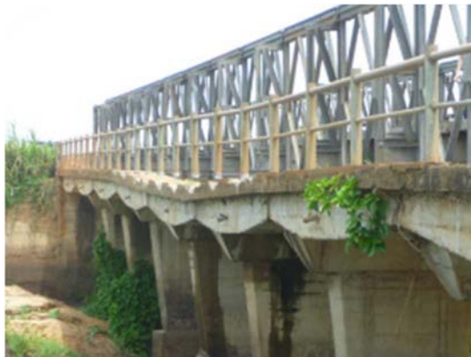
写真-3 メサロⅠ橋 2014年の洪水時に橋脚が沈下し、ベイリー橋により交通を供用。
