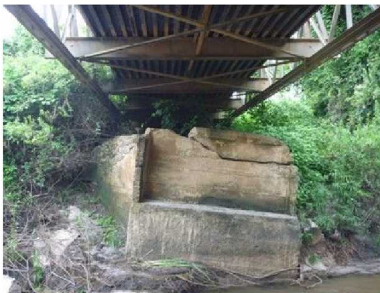
既設橋梁の損傷
