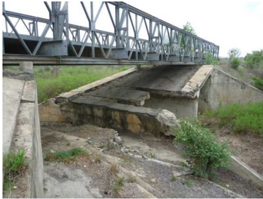
写真-1 カチブシ橋 2003年に洪水により落橋し、ベイリー橋により供用中。
