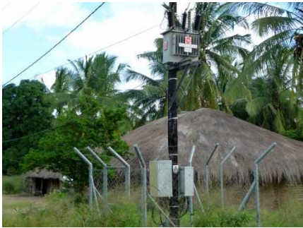
村の柱上変圧器
