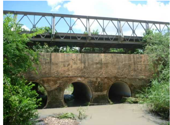
写真-8 ムンゴエ橋 パイプカルバートが沈下、崩壊し、ベイリー橋により供用中。
