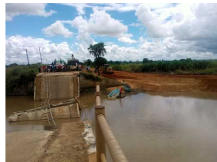
メサロ橋Ⅲの落橋
