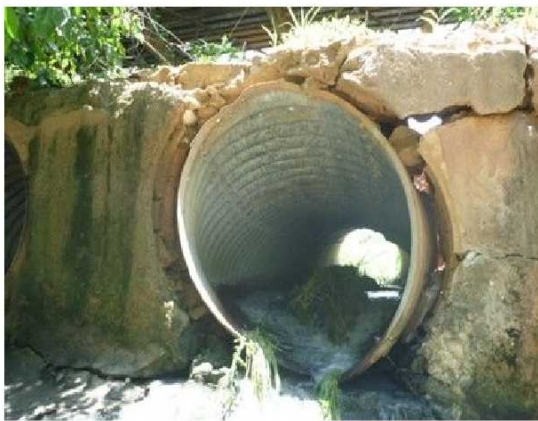
既設カルバートの損傷
