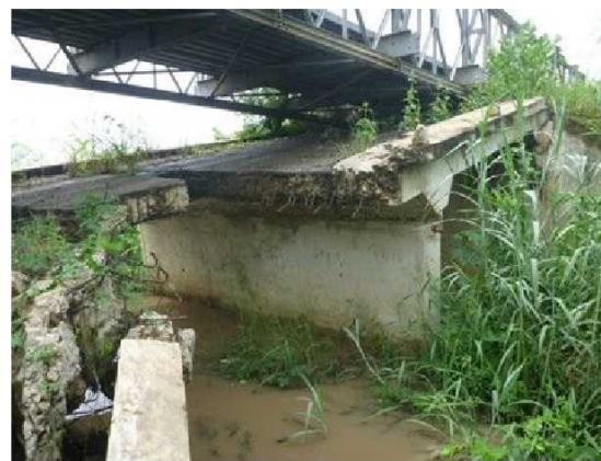
既設橋梁の損傷
