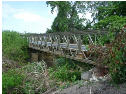
写真-2 ムアガムラ橋 下流にある落橋した既設橋は内戦中に爆破された。
