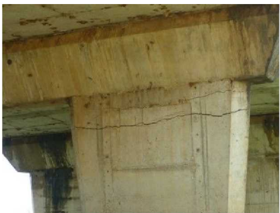
既設橋梁の損傷
