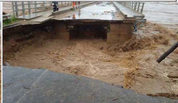
A1橋台背面の土工部は、下流側からの吸出しにより侵食が進行し最終的には崩壊した。
