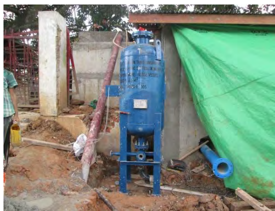
圧力タンク (フェーズ I プロジェクト)
