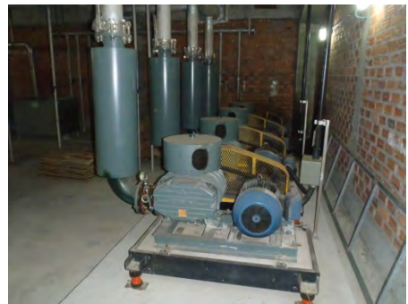
イオンモール内の汚水処理施設
