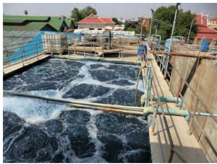
染色工場の汚水処理施設
