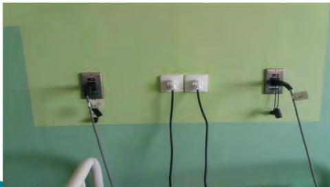
壁のコンセント
