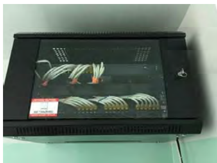
ウブルハンガイ RDTC 構内ネットワークルータ設置
