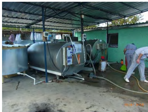
写真3 原料乳受入れのバルククーラー。 屋根付きの屋外に設置されていた
