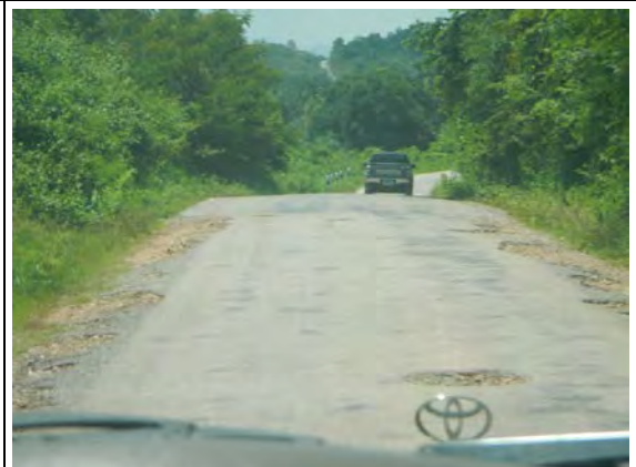
NR4A（サイニャブリ県、南側） DBST、W=6~7m、ポットホールが多い
