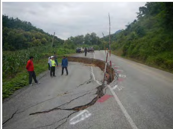
NR4（ルアンパバン県、北側） 地滑り1
