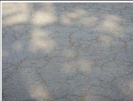
NR9（サバナケット県、サバナケット付近） 亀甲ひび割れ
