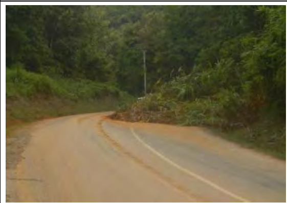
NR13N（ルアンパパン県、ルアンパパン南部） 土砂崩れ
