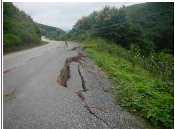
NR4（ルアンパバン県、北側） 地滑り2
