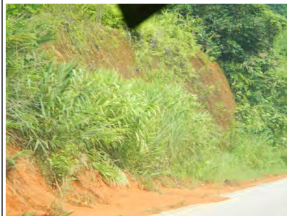
NR3（ルアンナムタ県、ルアンナムタ北側） 土砂が道路に流れ出ている
