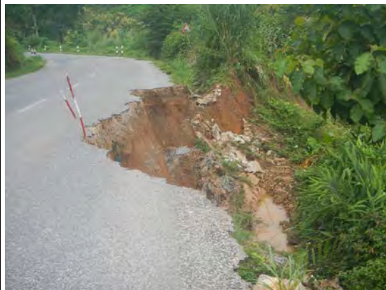
NR4（ルアンパバン県、北側） 地滑り3
