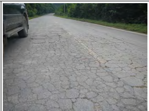
NR3（ルアンナムタ県、ルアンナムタ南側） 亀甲ひび割れが発生
