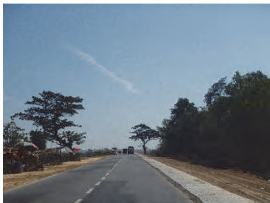
写真3 パヤジ～タトンの路面状況（パヤジ付近）
