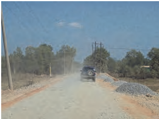
写真18 ザタピエン～エインドゥの路面状況
