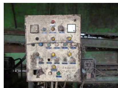
図9 操作が難しくなった制御盤
