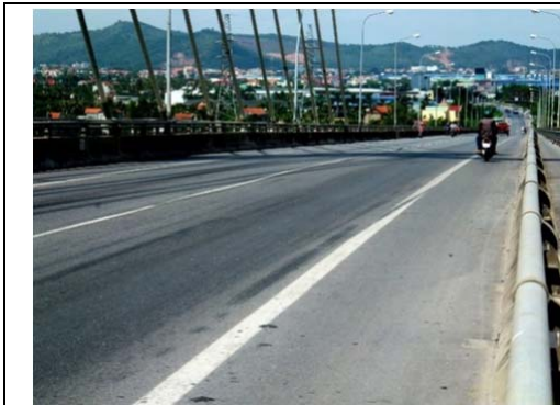
Bề mặt không bằng phẳng đã xuất hiện (phía bắc).
