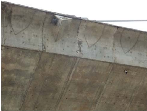
Nứt vỡ bê tông nhẹ được tìm thấy trên bụng dầm
