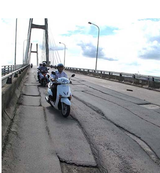
Tình trạng mặt đường cầu Kiền vào tháng 9 năm 2014 Nguồn: http://www.baohaiphong.com.vn/<03/09/2014>
