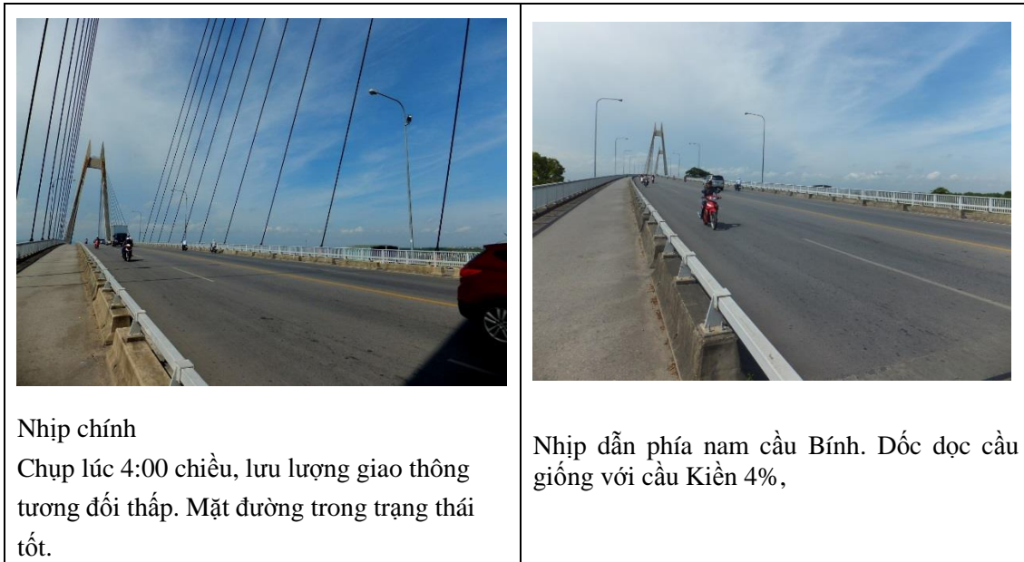
Hình 6.3-1 Hiện trạng áo đường cầu Bính
