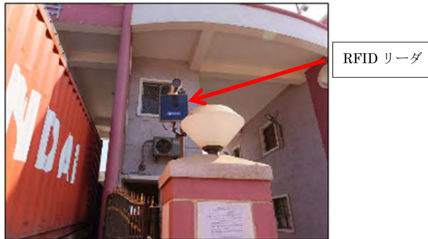
写真 3-8 港湾ゲート 1 構外入口付近の RFID 読取機
