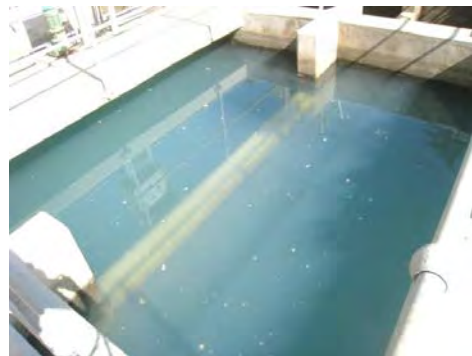
Toker WTP 水質改善トライアル状況 (清掃 後 のフロック形成池の状況：水の色 の違いが視認できる)
