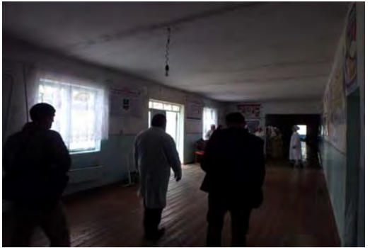
エントランスホール: 照明設備が少なく、非常に暗い。 看護師はこの共用部で執務している。
