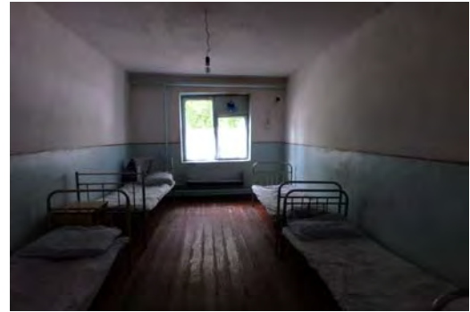
病室: 4床室。開口部が小さく、また照明設備が少ないため非常に暗い。暖房設備も老朽化により使用できない。
