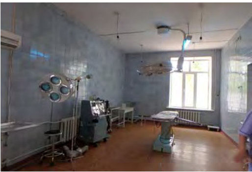
手術室: 清浄度を確保するための設備はない。冷暖房設備としてルームエアコンが増設されているのみである。
