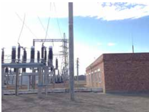
Зураг 35: Даланзадгадын Дэд станцууд
