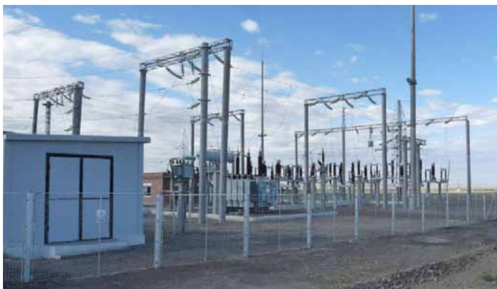
Зураг 3.3: Даланзадгад дэд станц
