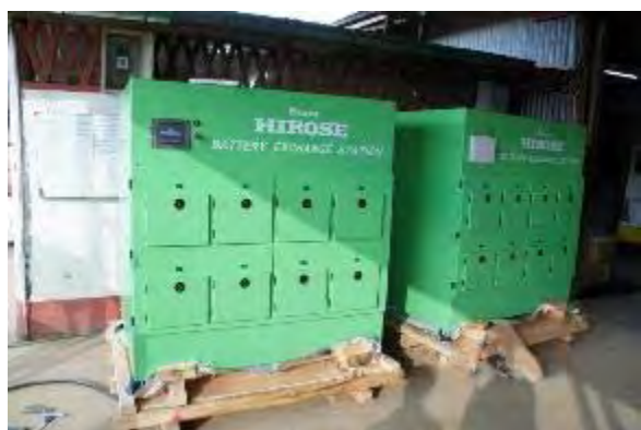
Laogreen 社車庫に到着したバッテリー交換機(2015年4月)
