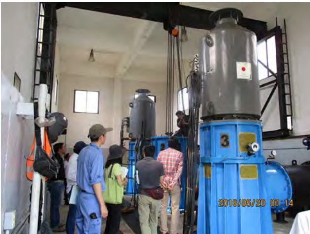
円借款事業で整備されたカタラマ揚水機場
