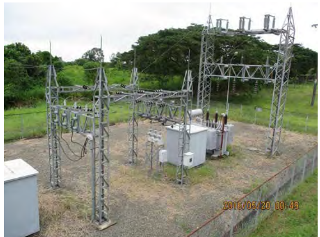
揚水機場における変電所
