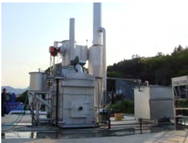
写真 3 二次燃焼室とサイクロン集塵装置
