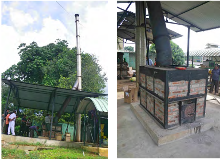
写真 15 Gampola Base Hospital の焼却炉
