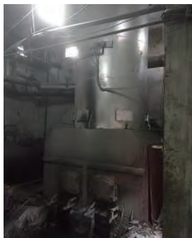
市場調査（繊維工場の台湾製ボイラー）
