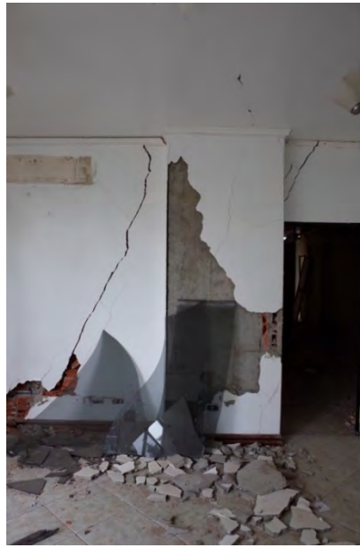
写真 3-34 内部の被害の様子
