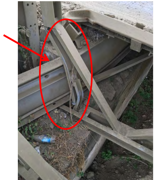
写真 3-9 同左の被害状況
