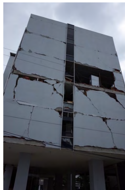
写真 3-33 被害を受けたインフィル外壁
