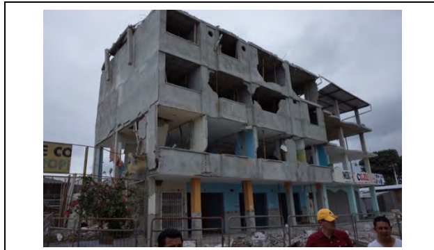
写真 3-18 建設中の集合住宅の被害状況
