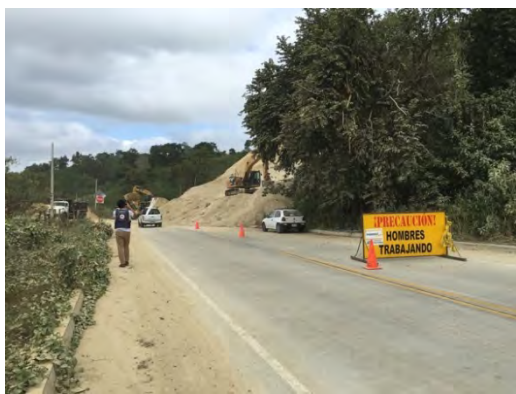
写真 3-6 斜面崩壊に伴う道路の閉塞
