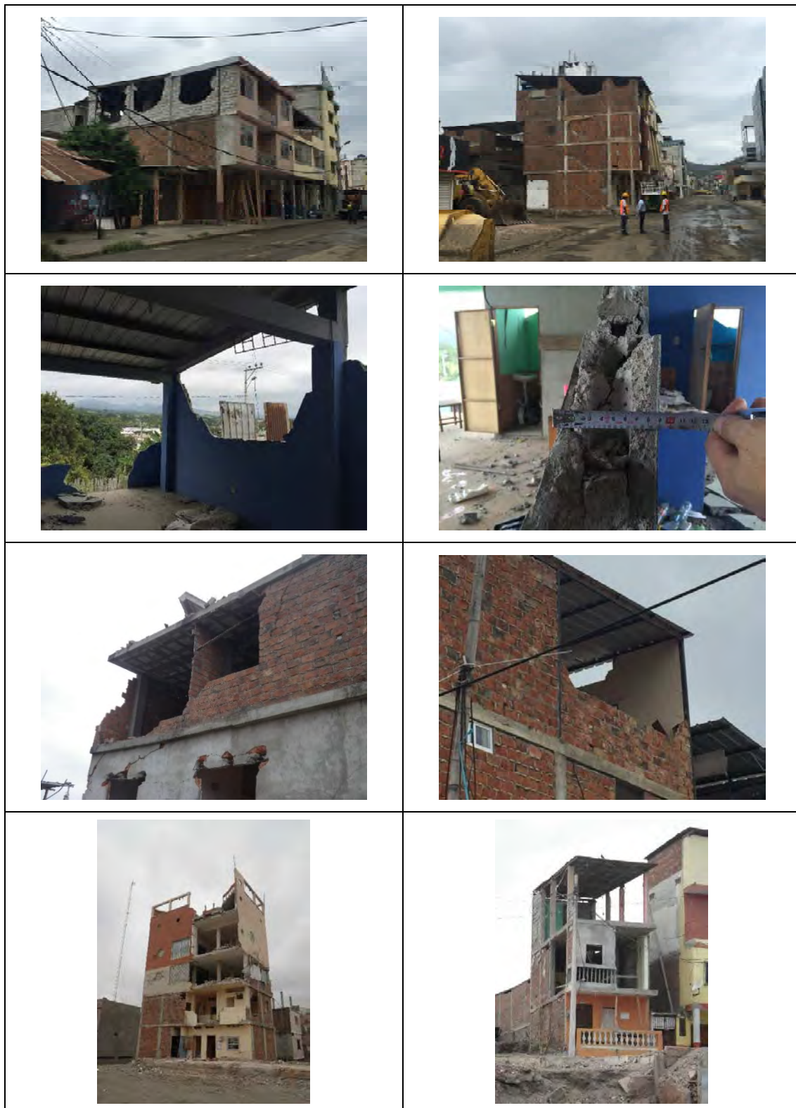
写真 3-37 典型的な面外崩壊の被害事例
