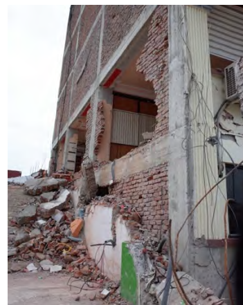
写真 3-15 崩れ落ちたインフィル外壁
