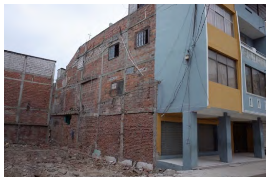
写真 3-27 倒壊し撤去された建物の跡地と残存建物
