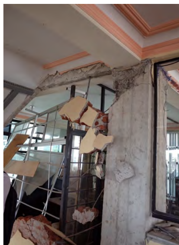
写真 3-16 崩れ落ちたインフィル内壁
