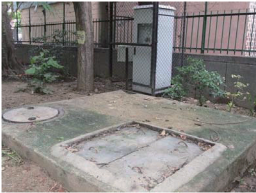
ビタンブラ地区の公園に設置されたチャンバーとパネルボックス。
