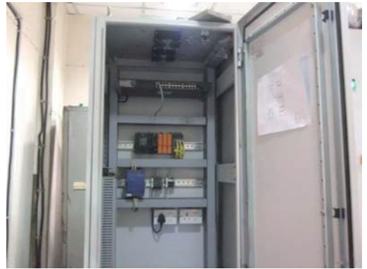
本プロジェクトによりビタンブラ配水池内に設置された SCADA。
