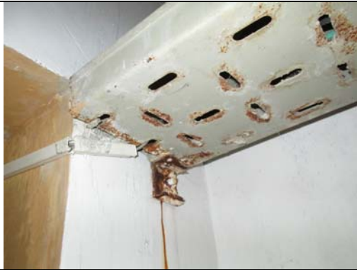
ケーブルラック
