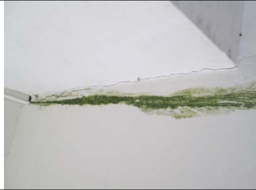
壁隅角部のクラックと漏水
