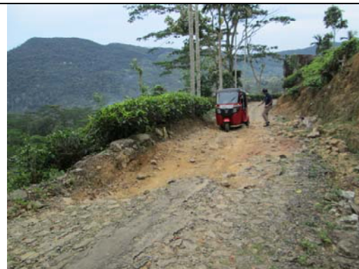
アクセス道路のコンクリート舗装の剥離
