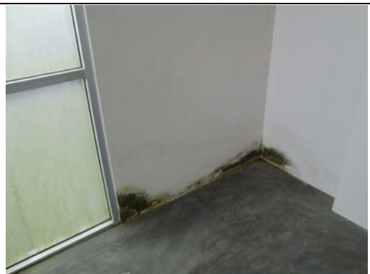
窓廻りからの漏水
