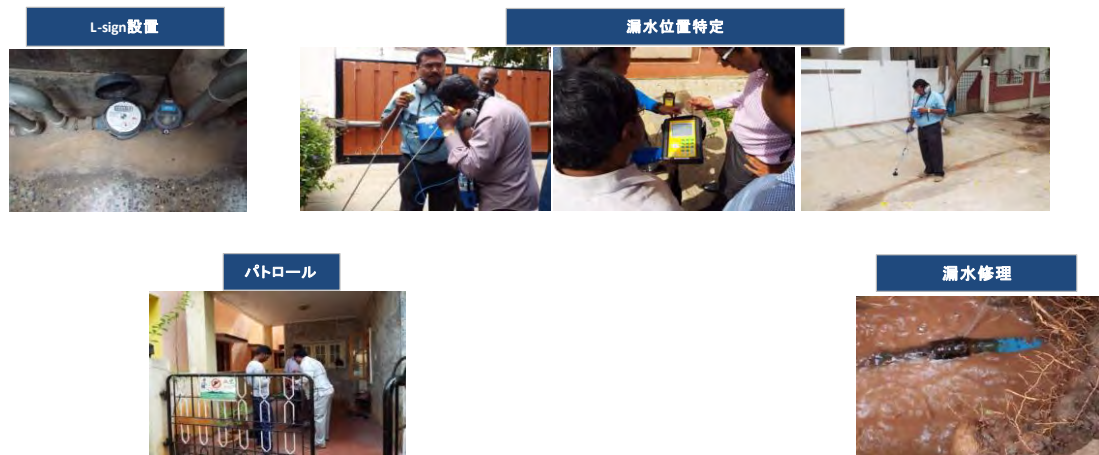
図 3-19 漏水調査形態写真
