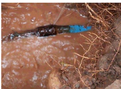
漏水箇所状況
