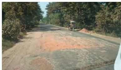
維持修繕が不十分な道路舗装
