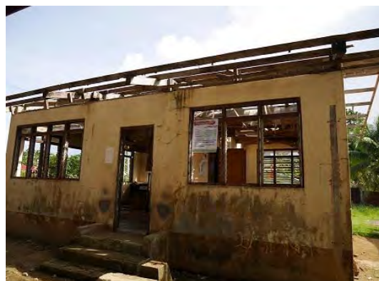
図 5-11 台風ルビーで破壊された バランガイ保健センター
