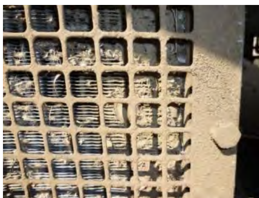
フィルターの目詰まり（オーバーヒートの原因）
