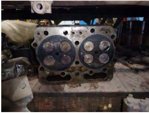
エンジン吸排気弁が破損した様子
