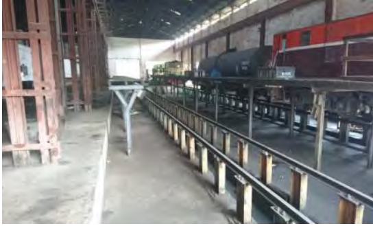
メンテナンス用ピットとデッキ
