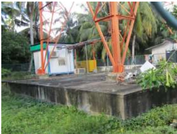
フィヨアリ：既設アナログ鉄塔基礎及び局舎
