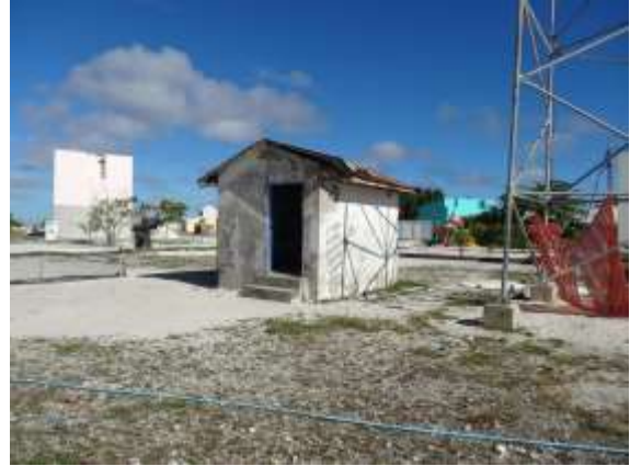
ナイファル：既設局舎
