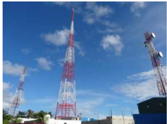
マレ（ビリギリ）：通信事業者の鉄塔
