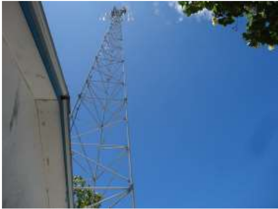
ウンゴファル：既設鉄塔
