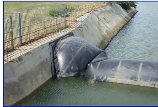
写真-2 旧式设计による本体肩部の形状 (出典：JICA 案件化調査団撮影) 【不適切な設計のラバーダム】
