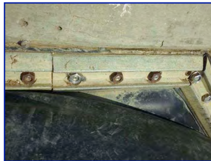
写真-9 不適当なボルトによる更新 (JICA 案件化調査団撮影)
