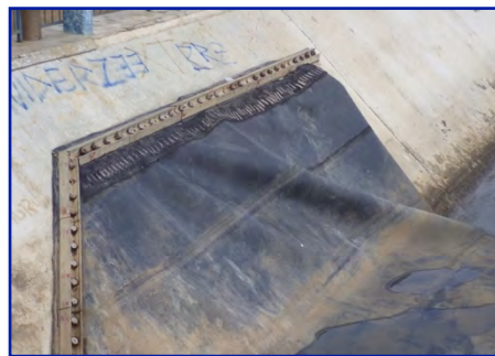
写真-5 旧式設計の法部金具配置 (JICA 案件化調査団撮影)
