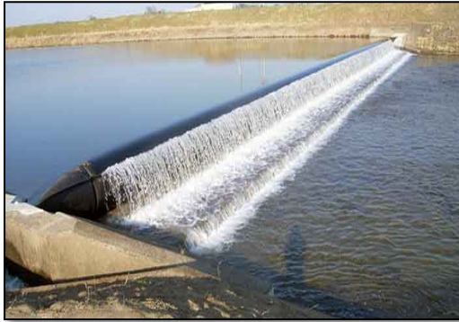
写真-1 ラバーダム全景 (出典：日本自動機工(株)社内資料) 【適正な設計のラバーダム】
