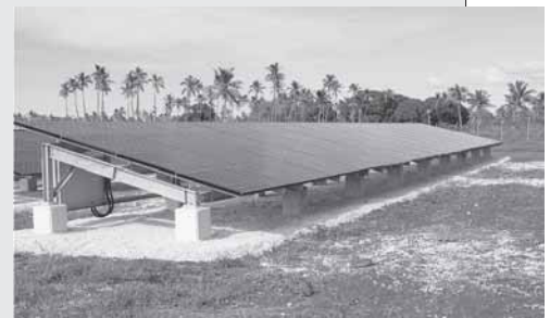
Una instalación para la generación fotovoltaica en Tonga.
