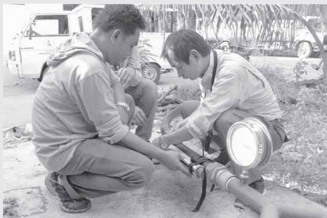
Un miembro de la delegación de Yokohama Water Co. Ltd. mide la velocidad de flujo en un ducto hidráulico, utilizando un flujómetro ultrasónico.
