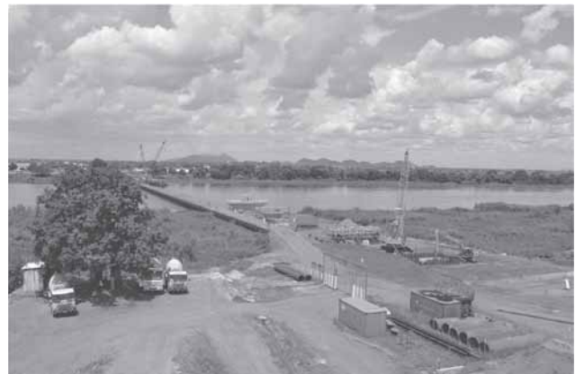
Un puente en construcción sobre el Río Nilo. En Sudán del Sur, la JICA pudo volver a sus actividades de cooperación, y en marzo de 2015 reanudó las obras de construcción del proyecto del Puente del Río Nilo (Freedom Bridge), símbolo del proceso de la paz. (Foto: cortesía de Dai Nippon Construction)
