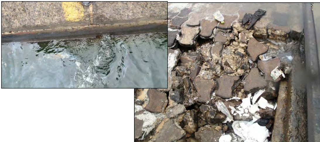
(3) Partie de la digue endommagée (infiltrations des eaux de pluie à partir de la couche de surface endommagée, écoulements vers la mer par les ruisselets).
