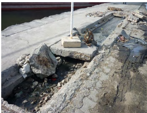
Photo 13 : Canalisations d'adduction d'eau endommagées sur le môle 3
