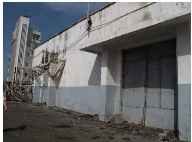
Photo 8 : Face Ouest de l'entrepôt (côté quai) (Auvent endommagé et porte qui n'ouvre plus)
