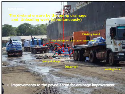
(4) Conditions difficiles des travaux de manutention
