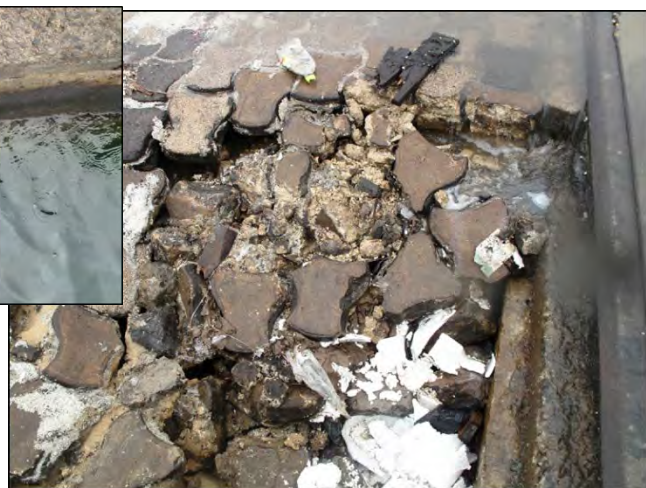
(3) 壊れた護岸部 (壊れた表層部から雨水が浸透し、水みちを通して海に流れ出る。)
