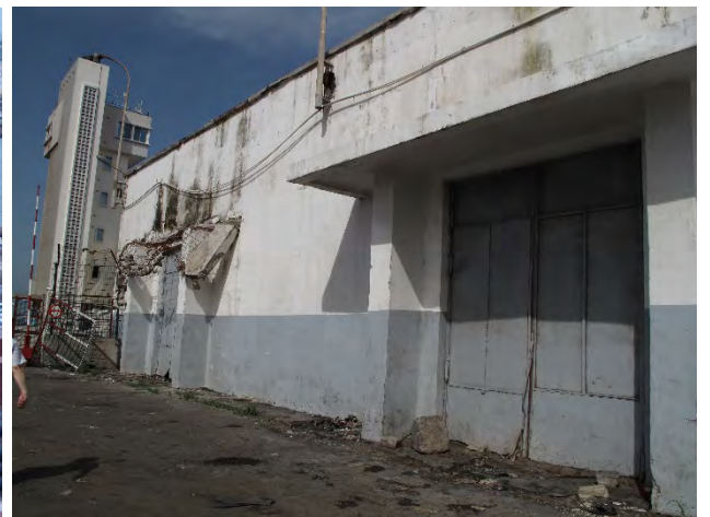
写真-8 倉庫西側(岸壁側) (壊れたひさしと閉じたままの扉)
