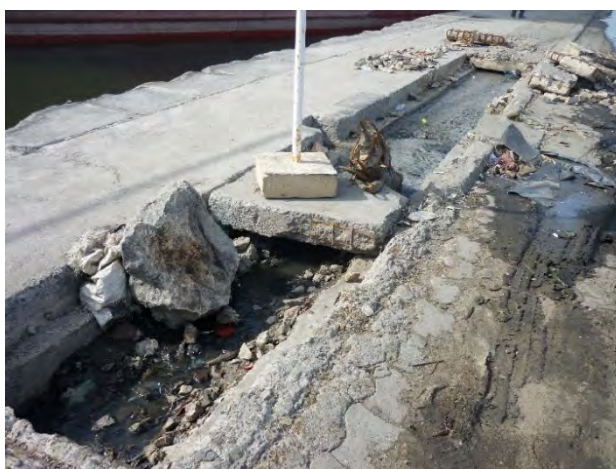
写真-13 第三埠頭給水管埋設部の破損
