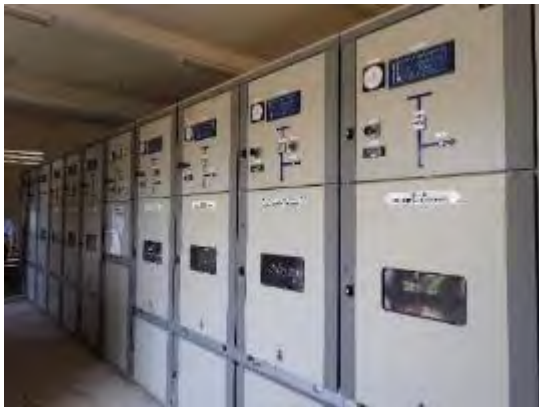
開閉所建屋内の既設配電盤
