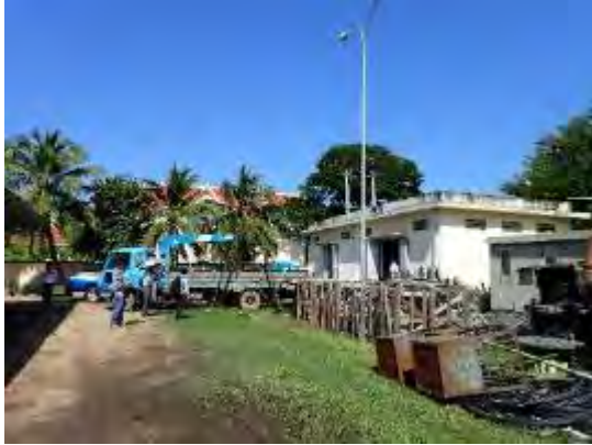
EDC スバイリエン敷地内の開閉所建屋
