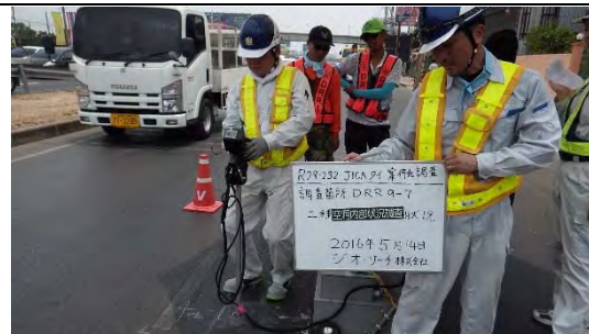
[空洞内部観察、撮影状況(郊外道路)]
