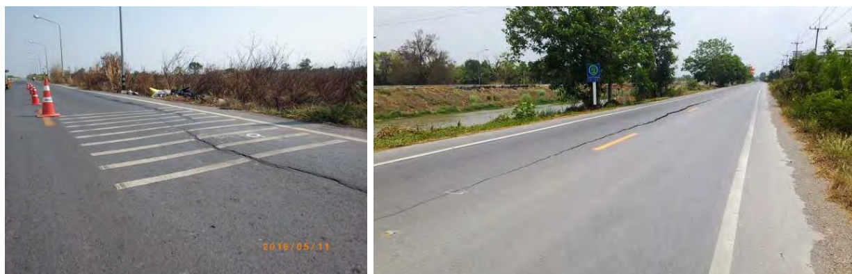
写真-3.7 2016年5月の路面状況[写真左：DRR3, 写真右：DRR4]
