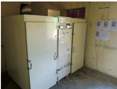
州農業省園芸局ナーサリー に設置した電気乾燥機
