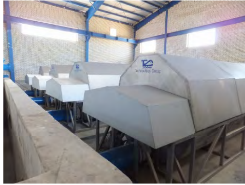
浄水場 (ストレーナ装置)
