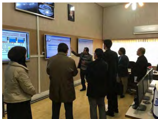
コントロールセンター
