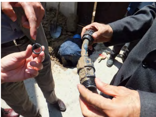
漏水修理 (パッキン劣化)
