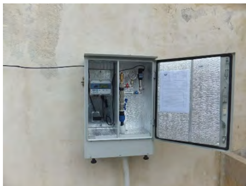
圧力モニタリング装置 (モスクに設置)
